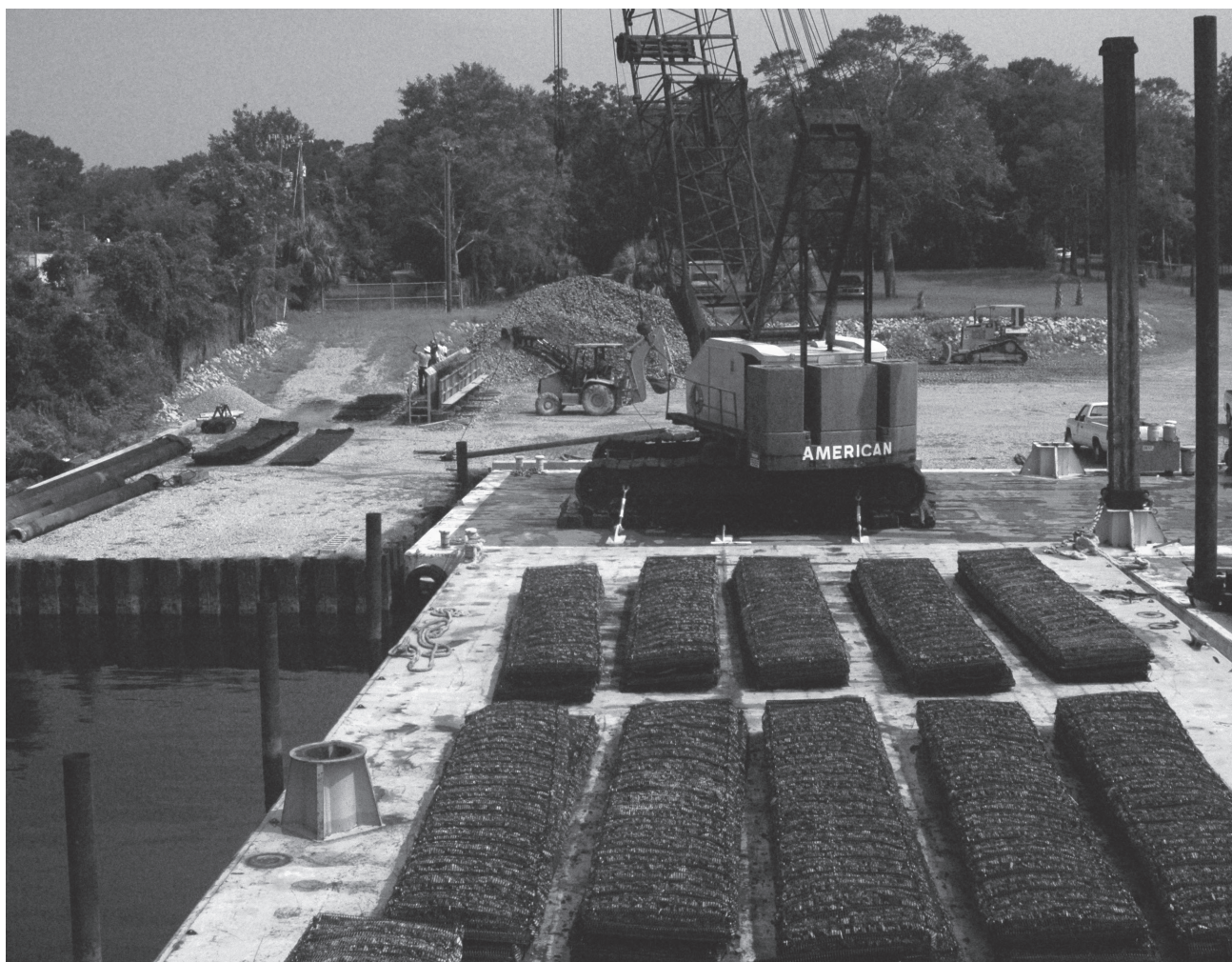
W Bay County na Florydzie materace oczekujące na wbudowanie nad rurociągiem pogrupowano i ułożono w stosy.
