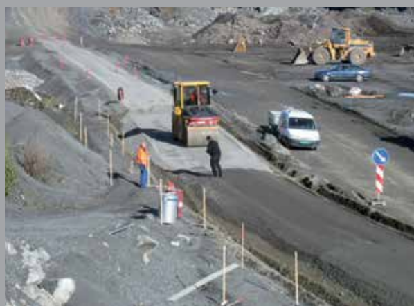
2004 – Jeden z najdłużej monitorowanych odcinków zlokalizowany w obciążonym ciężkim ruchem kamieniołomie Feiring Bruck, Norwegia.
